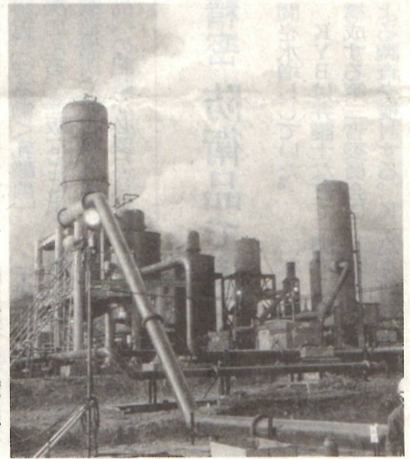
松尾八幡平地熱発電所が29日に稼働、東北電力に売電する(岩手県八幡平市)
